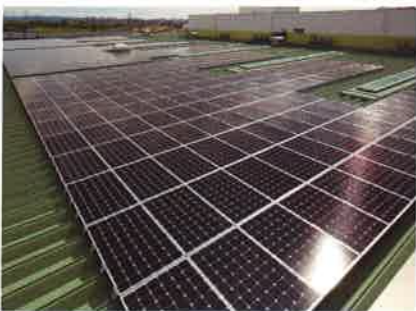
太陽光発電設備
